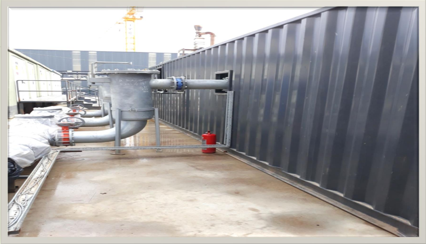
Booster ünitesi biyogaz giriş filtreleri.
