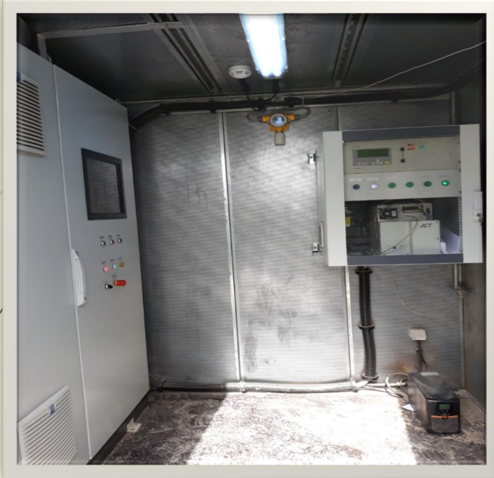
Booster ünitesi kontrol paneli ve on-line gaz analizörü.
