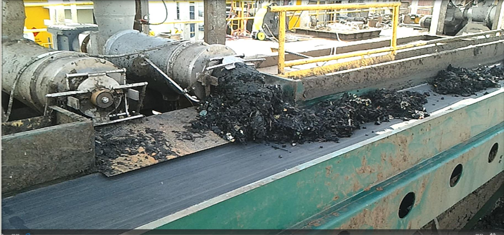
Sıkma ( susuzlaştırma ) üniteleri.
